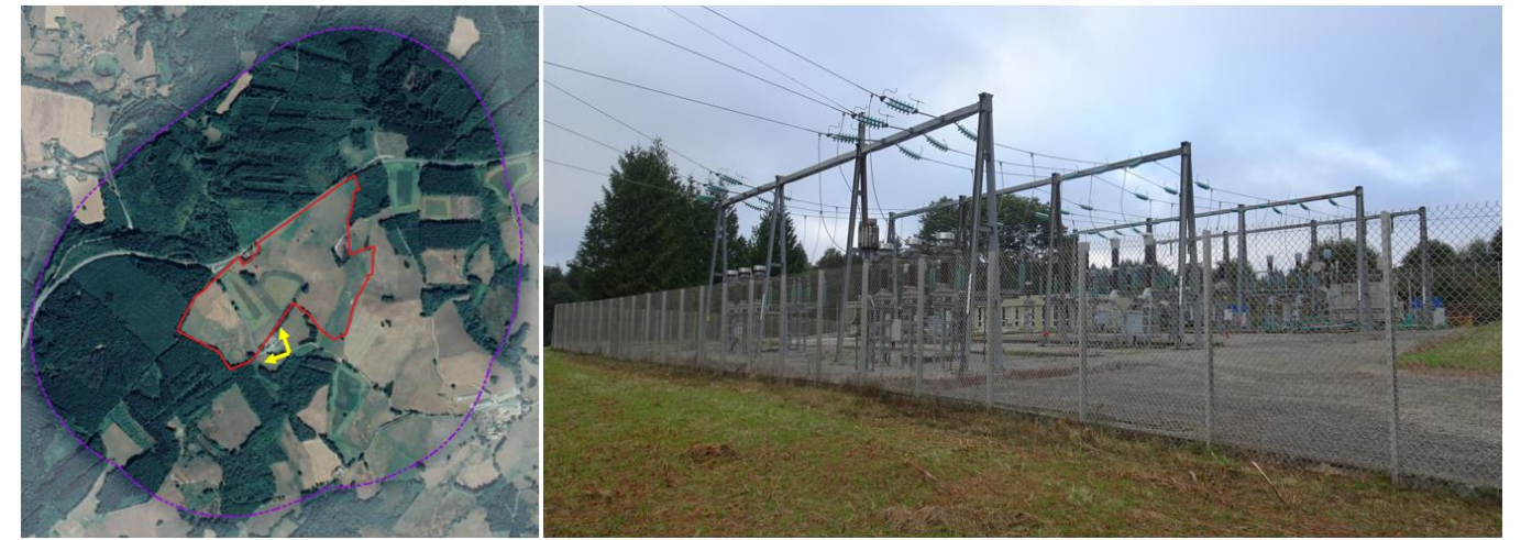
Figure 190 : Photographie illustrant le poste source présent au centre de l'AEI (Crédit photo : NCA Environnement)
